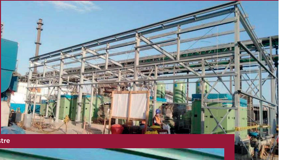
Sala de Compresores Aceros Arequipa - Soportería de Ductos
