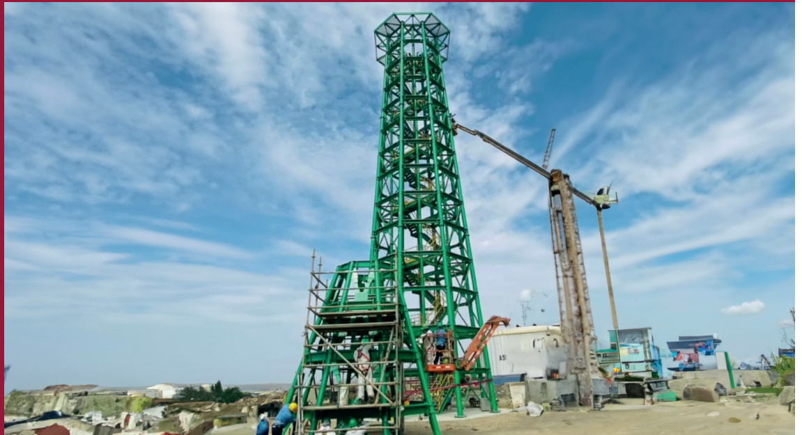
Torre de Antena Octogonal
